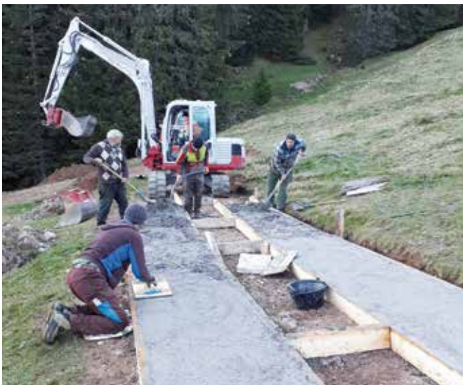
Neue Betonspuren Unterstetten
