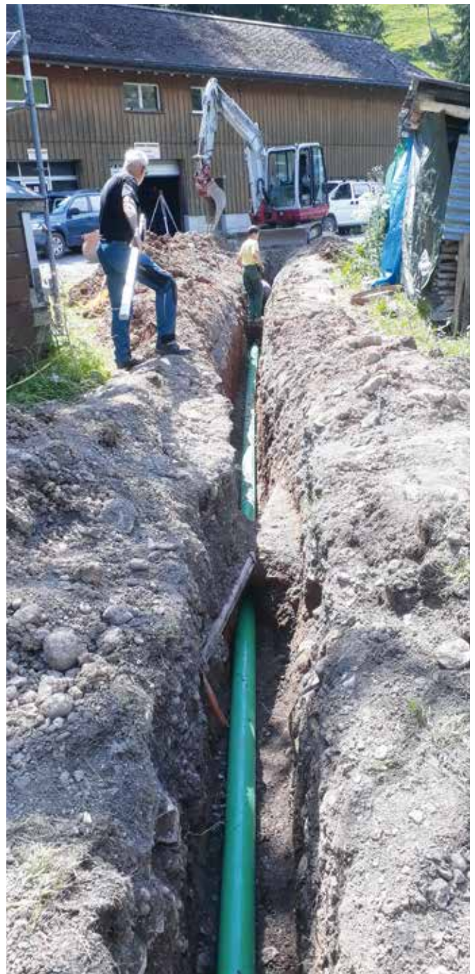
Wasseranschluss Magazin Klösterli
