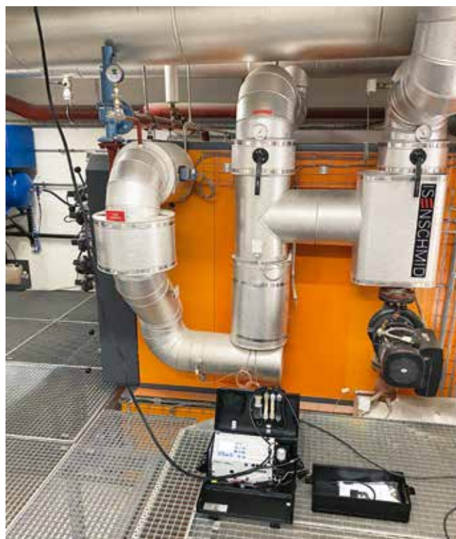
Emissionsmessung Heizzentrale Arth
