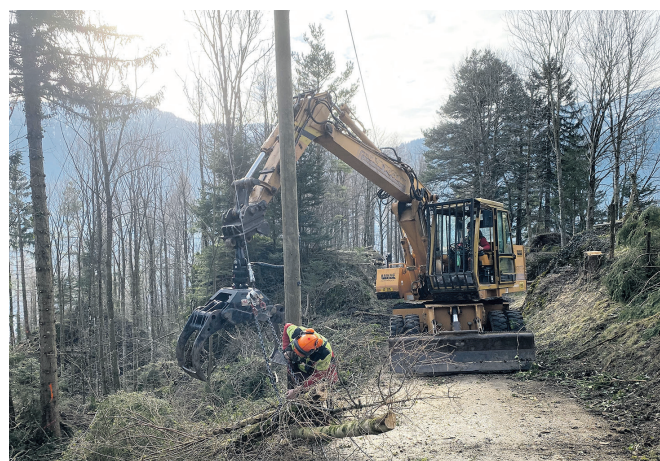
Holzschlag im Schutt
