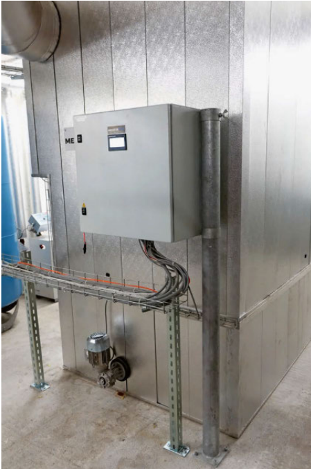
Der Elektro-Feinstaubfilter benötigt mindestens 90 Grad Abgastemperatur, sonst geht die Filterleistung zurück. Deshalb läuft im Sommer meist nur der Gaskessel.
