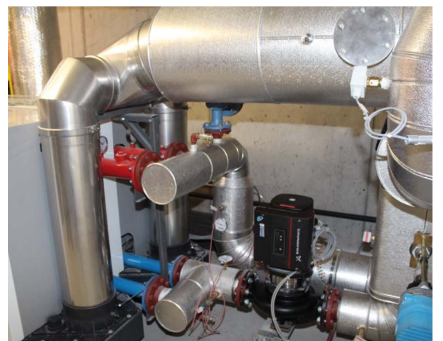
Wenn im Falle eines Falles nichts mehr läuft, wird die Schnitzelheizung mit Gas betrieben.
