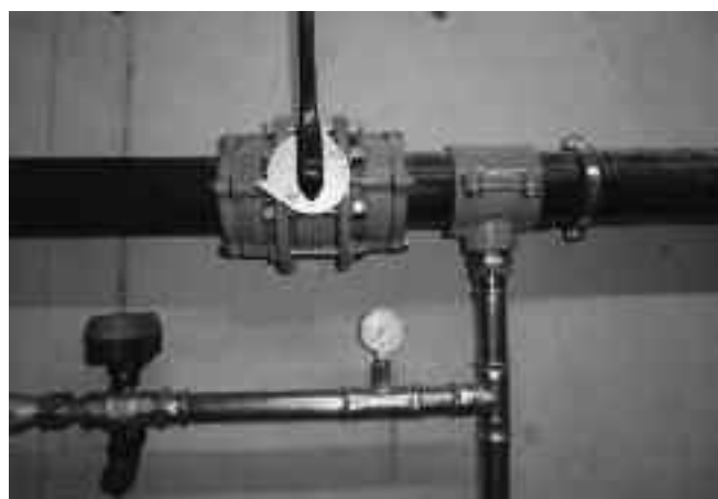
Wasserverbundstelle Rigi First
