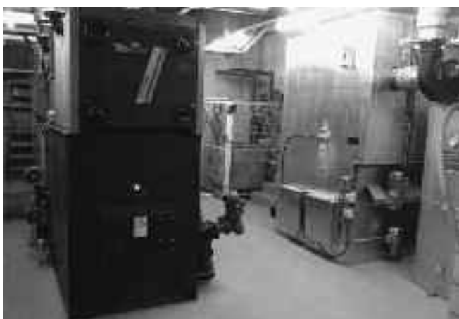
Heizkessel und Feinstaubfilter Schulhaus Sonnegg
